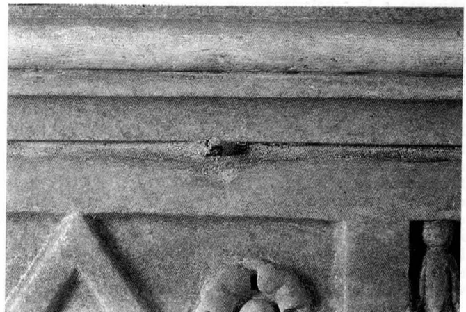
II - ROMA, CONVENTO DEI FILIPPINI - FRANCESCO BORROMINI: CAMINO MONUMENTALE NELLA SALA DELLA RICREAZIONE FREGIO DELL'ARCHITRAVE: UN ELEMENTO METALLICO INSERITO NEL GIUNTO CON IL BLOCCO DELLA CORNICE
