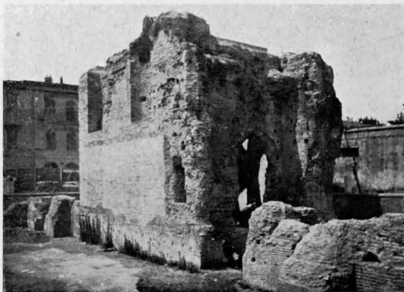
Fig. 2. PISA: Terme romane. Il rudere della sala ottagonata dopo i lavori di liberazione e consolidamento. (Foto Orsolini).
